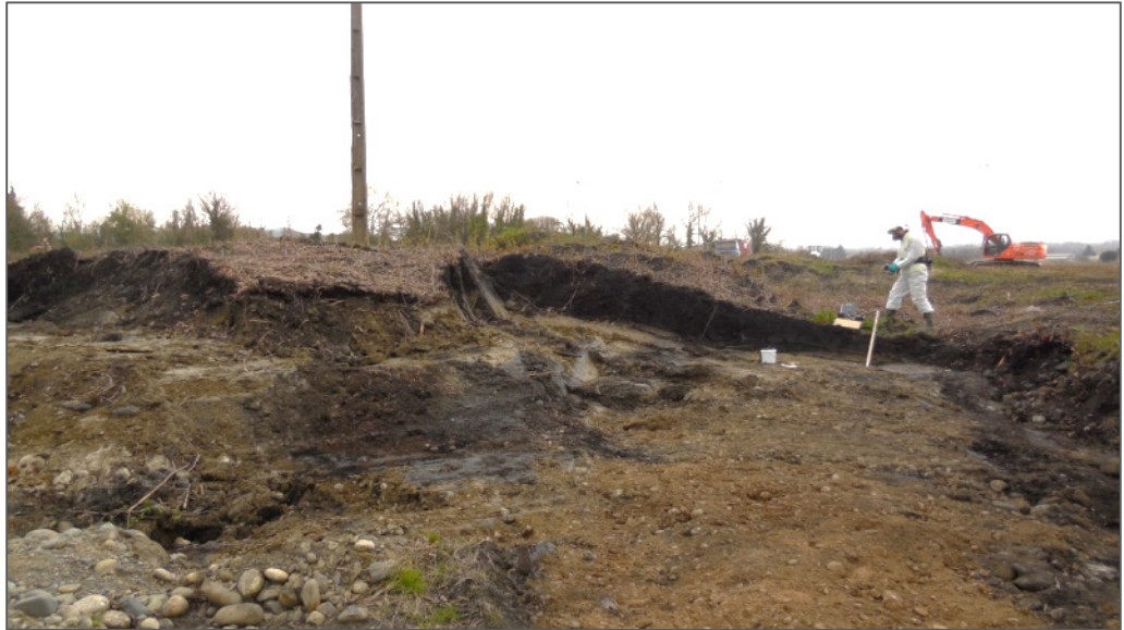
Photographie 13-1 : Parcelle 20 : Spot de pollution en cours d'excavation (vue du nord) - au centre, horizon superficiel de noir de carbone
