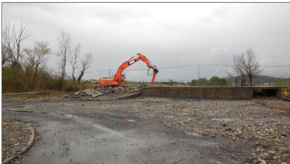
Photographie 12-1 : Parcelle 18 : destruction du quai de chargement au BRH (vue du sud-ouest)
