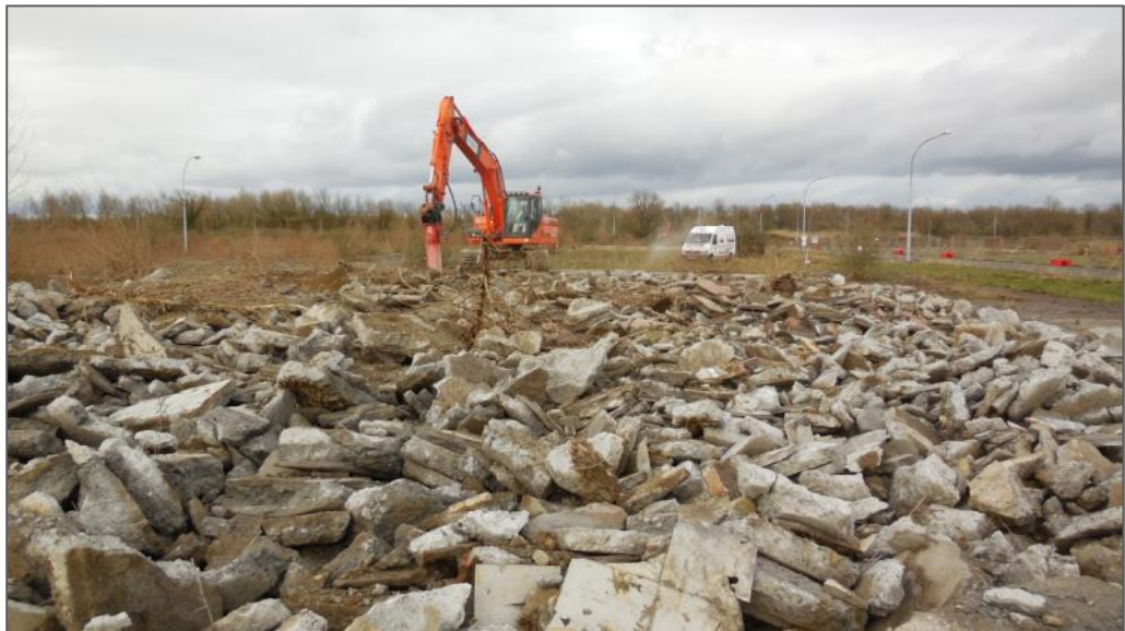
Photographie 5-3 : Parcelle 8-est : destruction des dalles bétons:
